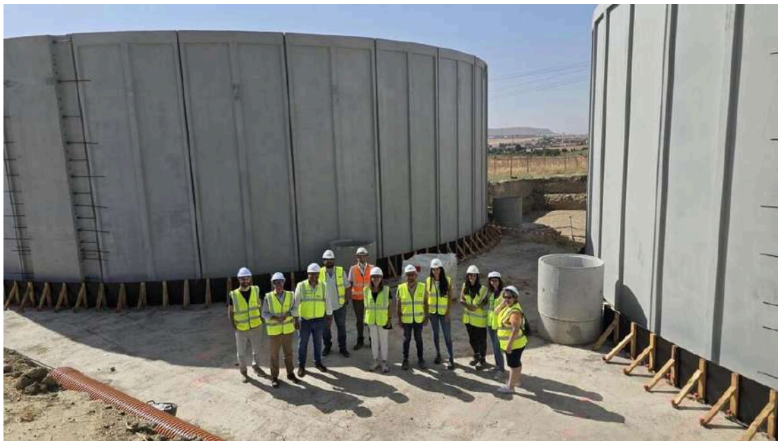
Yuncler y Villaluenga estrenan un nuevo depósito de agua - Foto: JCCM
